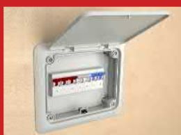
prekidača strujnog kruga
