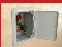
priključka za vodu
